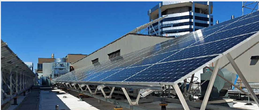
Panneaux solaires sur l'immeuble Arthur Meighen à Toronto
