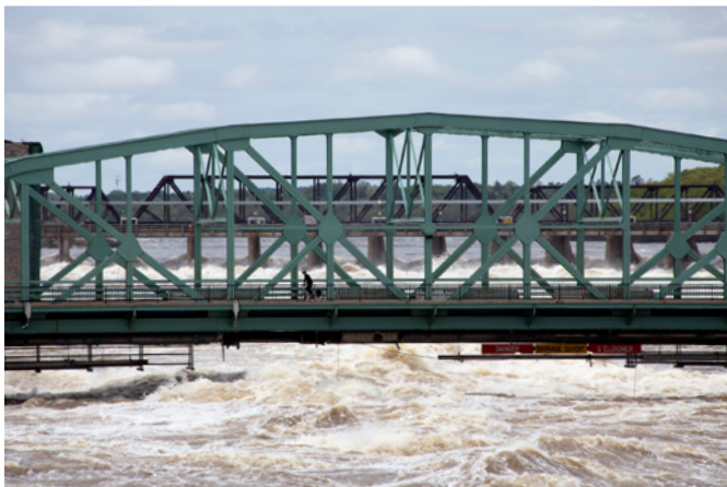
Inondation du Pont des Chaudières.
