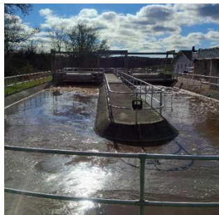
Station d'épuration des eaux usées, Établissement Warkworth, région de l'Ontario
