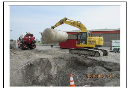
Réservoir de stockage de pétrole souterrain Complexe Archambault, région du Québec
